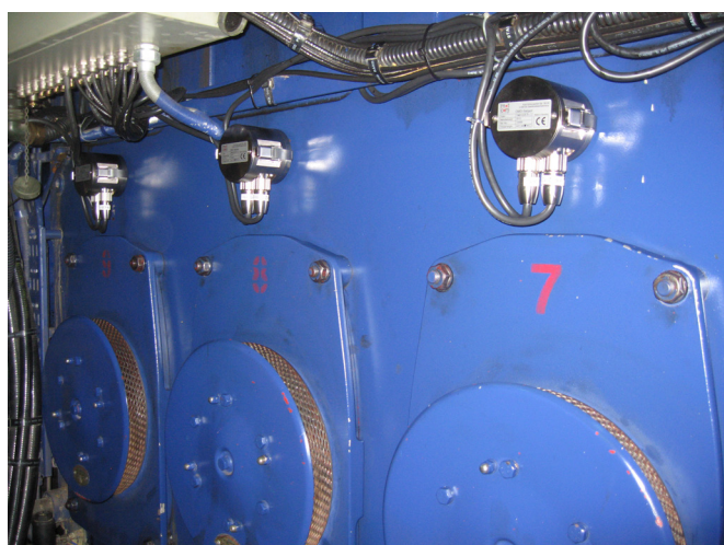
Fig. 2.1. Ejemplo de instalación para sensores y SOG
